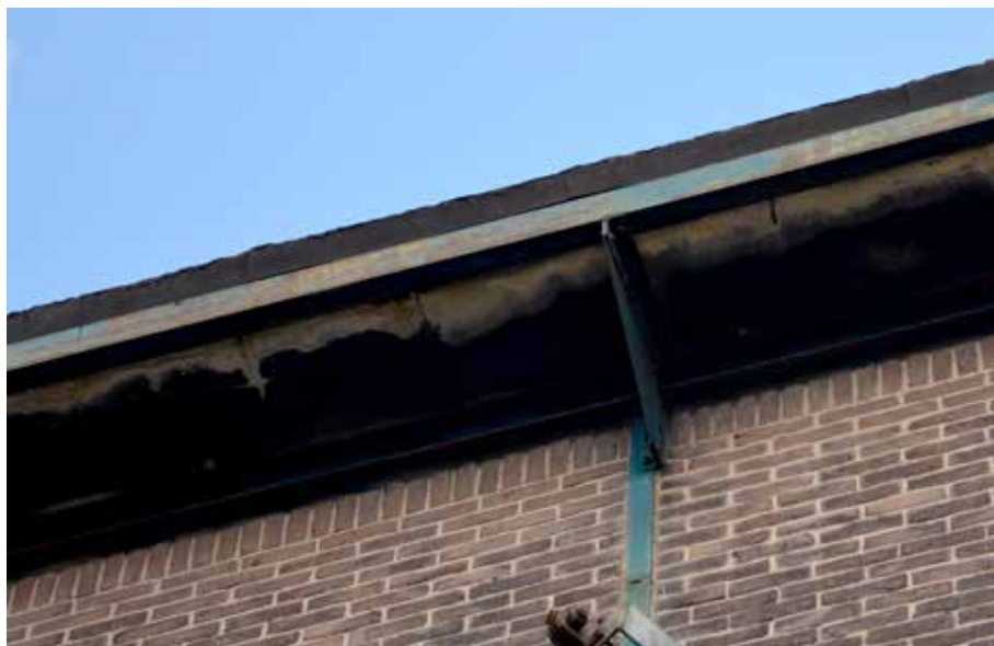
Afb. 22 De overstekende betonelementen aan de dakrand zijn in slechte staat.
