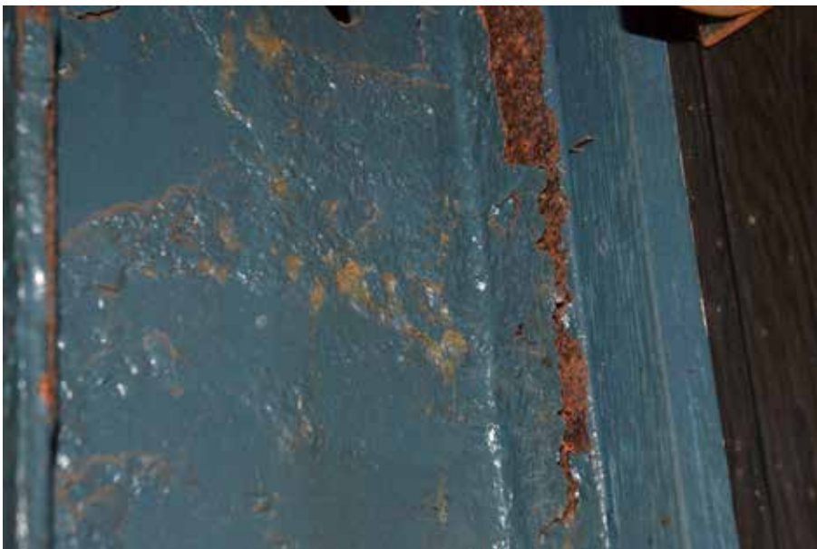
Afb. 27 Diverse staalprofielen in de westgevel vertonen roestvorming.
