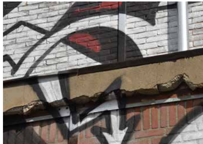
Afb. 21 De betonnen dakrand met dakbedekking in de overgangszone naar het hoogste deel van de zuidgevel is in slechte staat.
